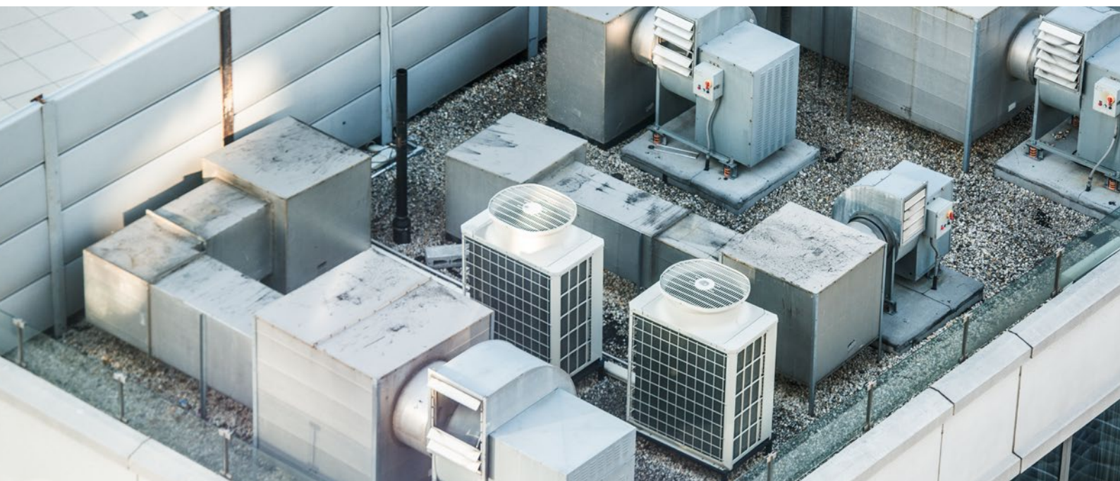
Fig. 6.5 – Echipamente grele pe clădiri
