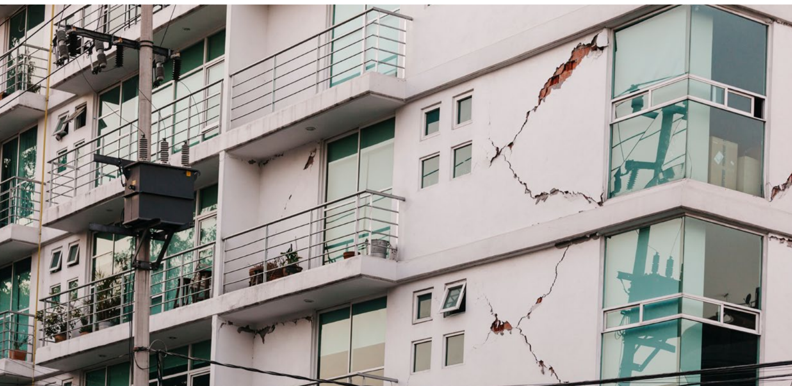
Fig. 4.6 – Degradare structurală datorată depășirii rezistenței elementelor structurale.
