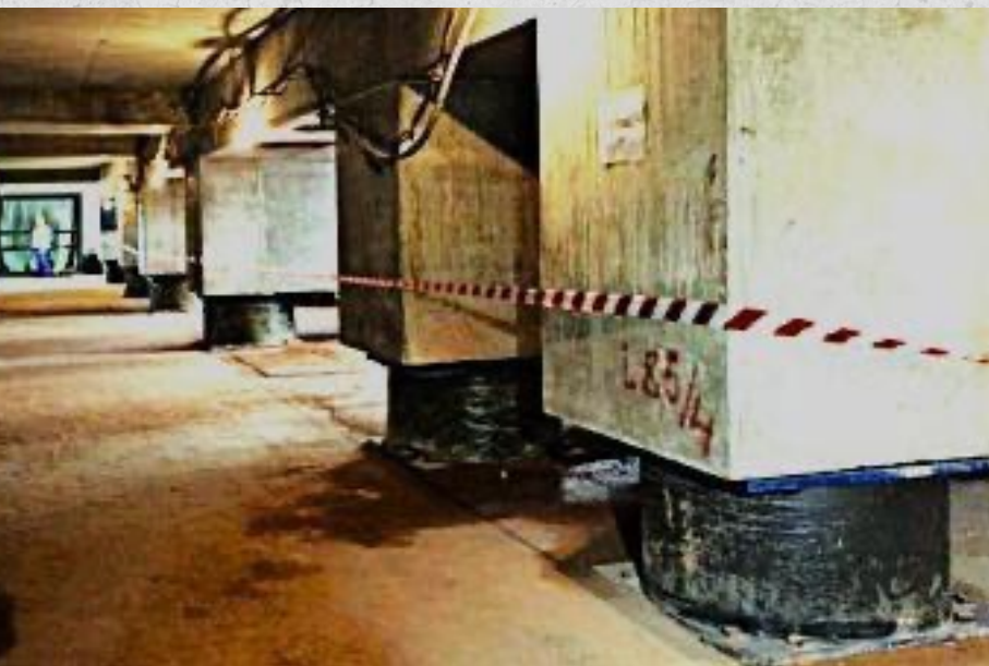
Fig. 5.11.a – Izolatori seismici - aplicare reală
