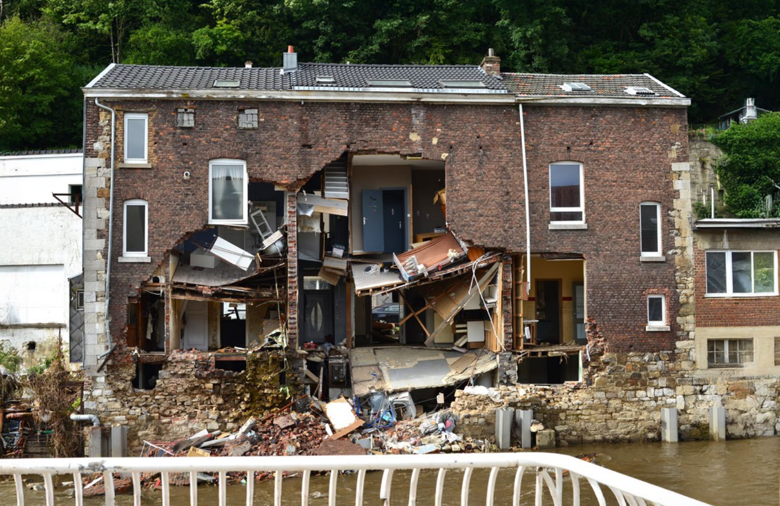
Fig. 6.9 – Cedarea parțială a peretelui fațadei nu a condus la colapsul general al structurii suficient de robuste.
